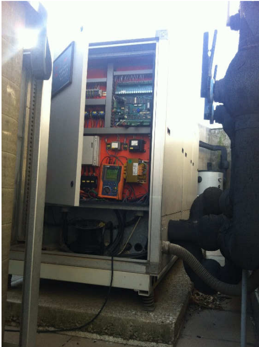
Enfriadora con el analizador de redes
